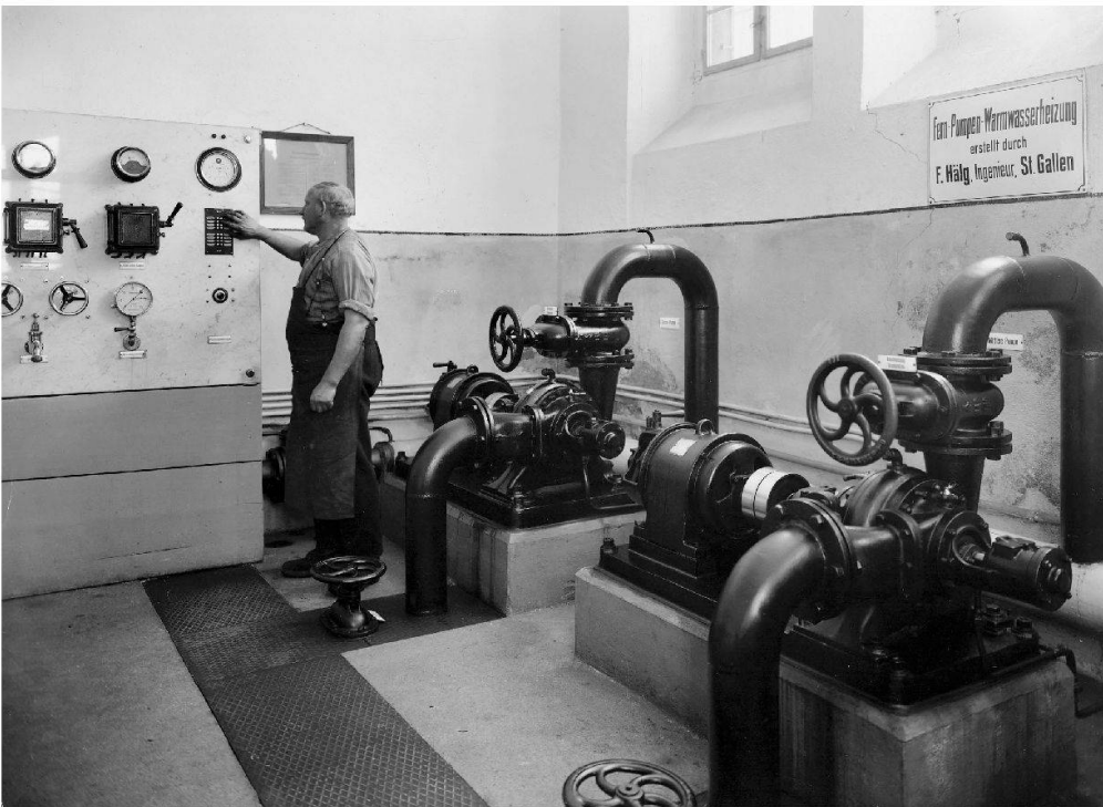
Abb. 30: Die Pumpen der neuen Heizung (Bild: Marthaler, Stella-Photo, Einsiedeln).
