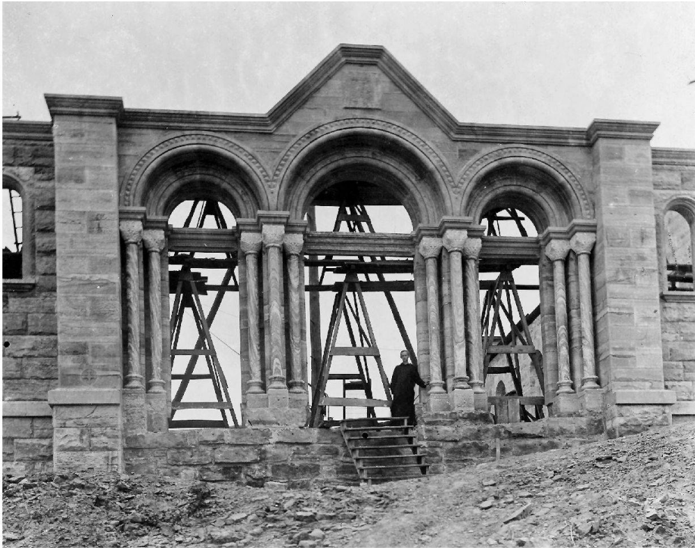
Abb. 36: Bau des Hauptportals von St. Meinrad (Indiana). Am 2. September 1887 brannte das Kloster ab. Es wurde sofort mit dem Bau eines neuen, grösseren Klosters begonnen.
