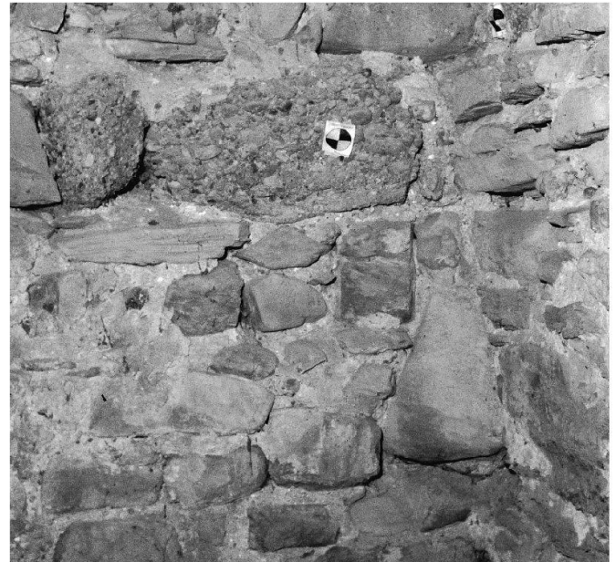
Abb. 8: Sattel SZ, Morgarten, Letziturm. Nachträglich zugemauertes Gerüstbalkenloch auf der Innenseite der Nordwand des Sockelgeschosses; von SSW.
