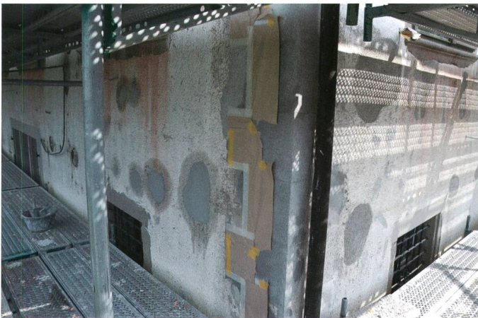
Abb. 26: Mit altem Handwerk konnte die 116-jährige Kalk-Kieselwurf-Fassade restauriert werden. Hausherr und Unternehmer arbeiteten dafür Hand in Hand.
