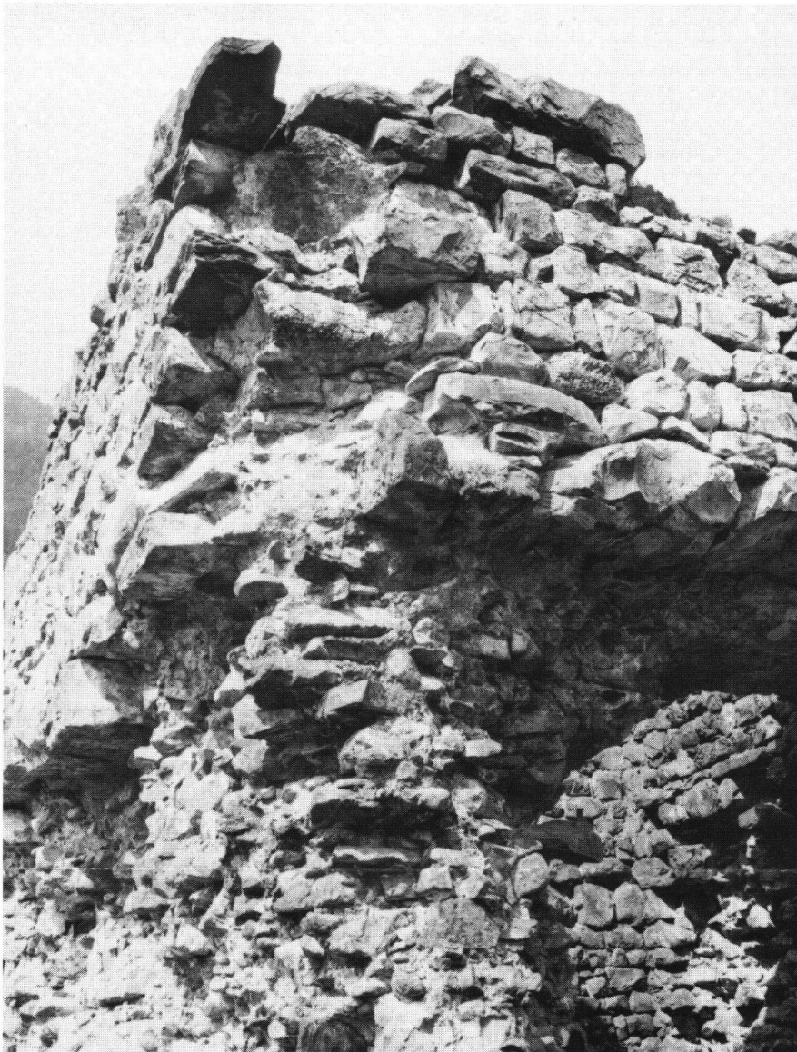
Seedorf, Burgturm, schwer beschädigte Ostecke
