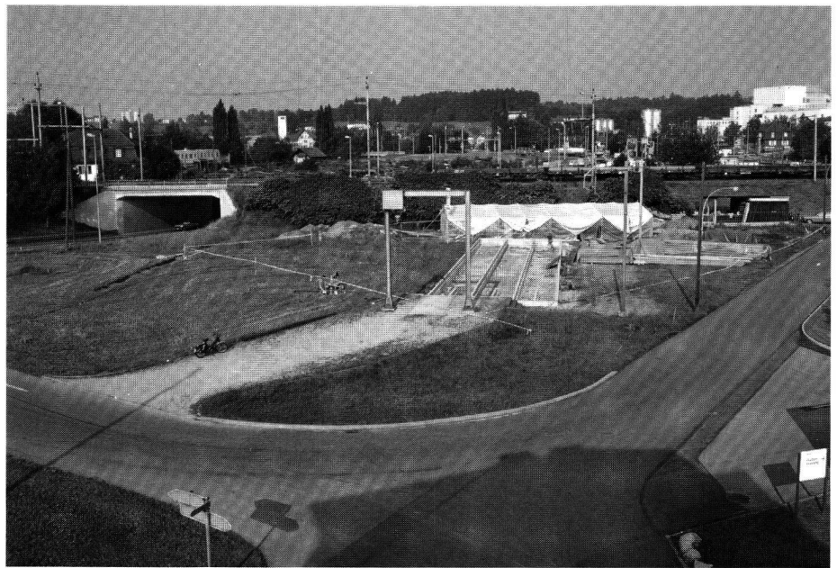
Emmen, Schachenstrasse. Übersicht über das Grabungsgelände. Mit einem Markierband ist der Verlauf der Umfriedungsmauer gekennzeichnet.
