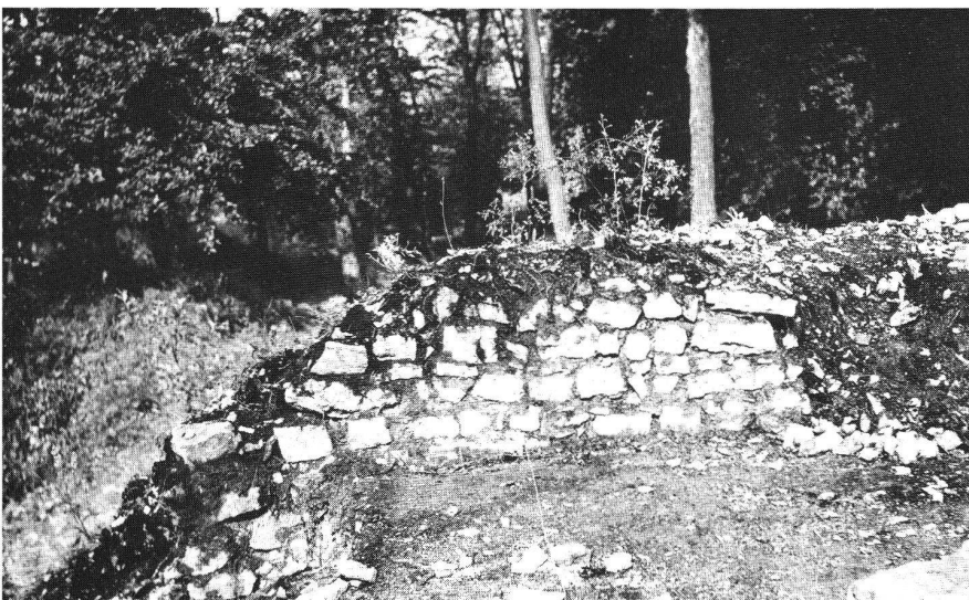
Dreimal dasselbe traurige Bild: Mauerwerk einer Burg, von Schwarzgräbern freigelegt, dann sich selbst überlassen und somit dem Zerfall preisgegeben. Oben: La Tur/Fardün (GR). Mitte: Unterwegen bei Pagig (GR). Unten: Vorder-Wartenberg bei Muttenz (BL). Die Aufnahmen sind um 1960 entstanden, mittlerweile haben sich die betreffenden Mauerteile weitgehend aufgelöst.
