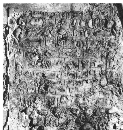
Abb.10 «Feinmaschiger» orthogonaler Fugen- strich von 1318 im Erdgeschoss.
