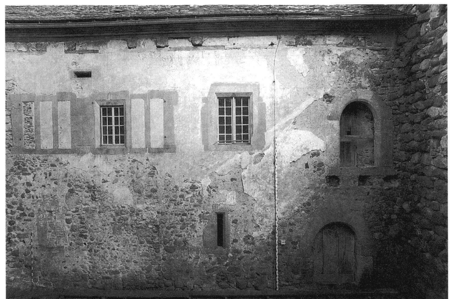
Palas von 1318. Südfassade mit dem Erdgeschoss-Portal in den unteren Saal und dem Hocheingang in den oberen Saal. Im Westen die vermauerten Scharten der Wohnstube.
