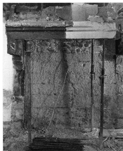
Fig. 11: La cheminée de la pièce sud du premier étage. (Claude Bornand, Lausanne)
