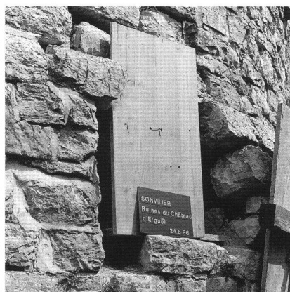
6: Même détail 1996. L'éclatement a eu lieu ... La nécessité d'intervenir saute aux yeux.
