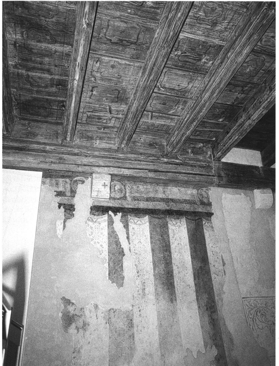
7: Lausanne – Rue de la Cité-Derrière 28. Le décor de draperies conservé sur la paroi sud de la chambre.
