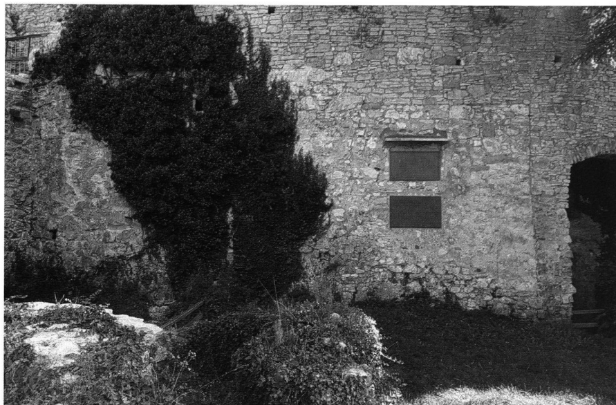
6: Innenseite (M1) des Grossen Bollwerkes von Südwesten im Zustand 1999. Links des Bewuchses ist das grossblockige Mauerwerk (M1a), rechts davon das kleinteilige Mauerwerk (M1b) zu erkennen. Man beachte die horizontal verlaufende Krone und die südöstliche Ecke des kleinteiligen Mauerwerks.
