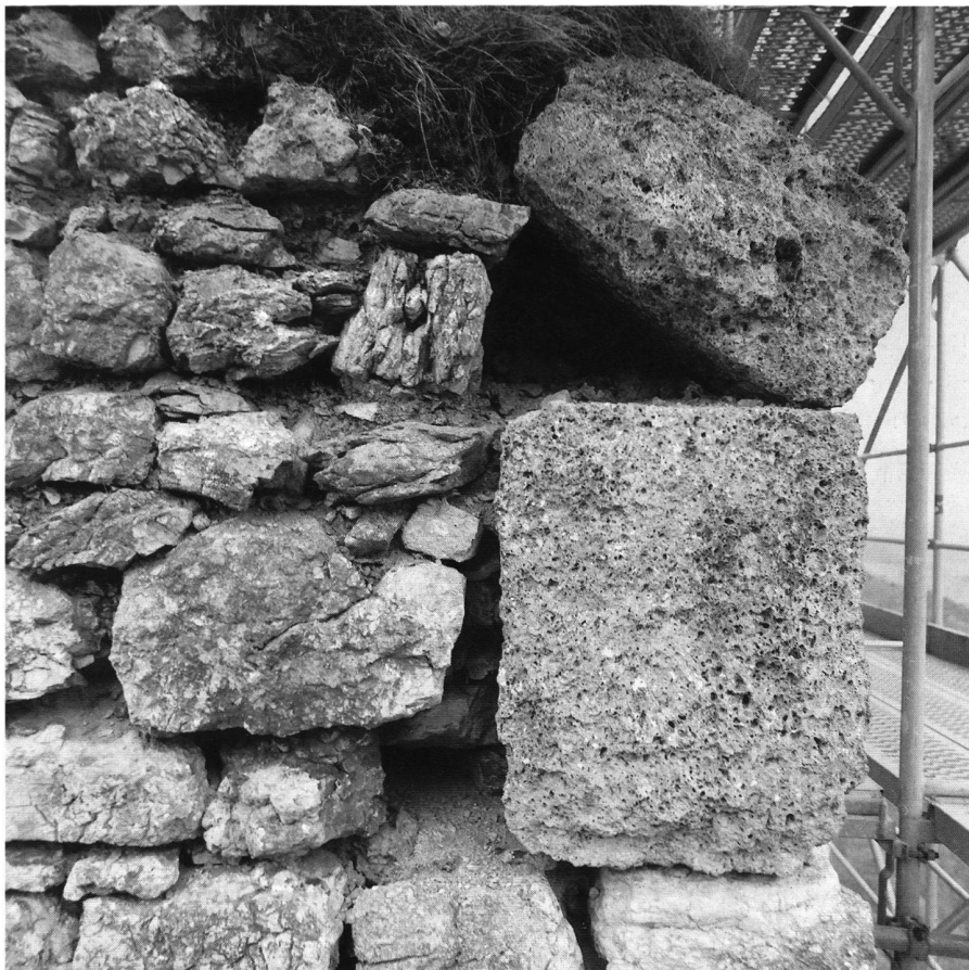
9: Arête des murs M1/M7. Les deux derniers blocs à bossage en tuf conservés au sommet de la chaîne d'angle; vue de l'W.
