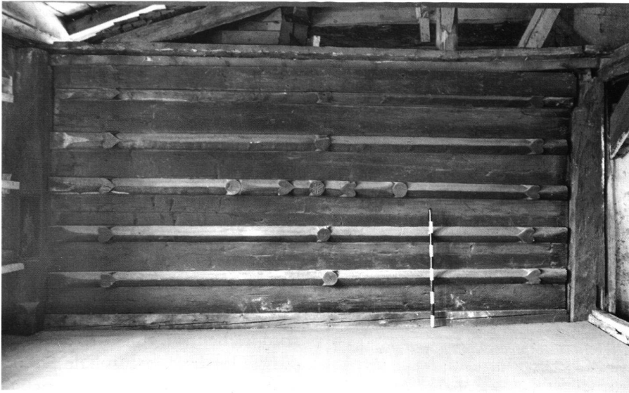
11: Haus Nr. 8: Bohlenbalkendecke aus der Stube, später im 2. Obergeschoss als Wandausfachung zweitverwendet. Diese Decke von 1409 d zählt weiterberum zu den frühesten dieser Art.
