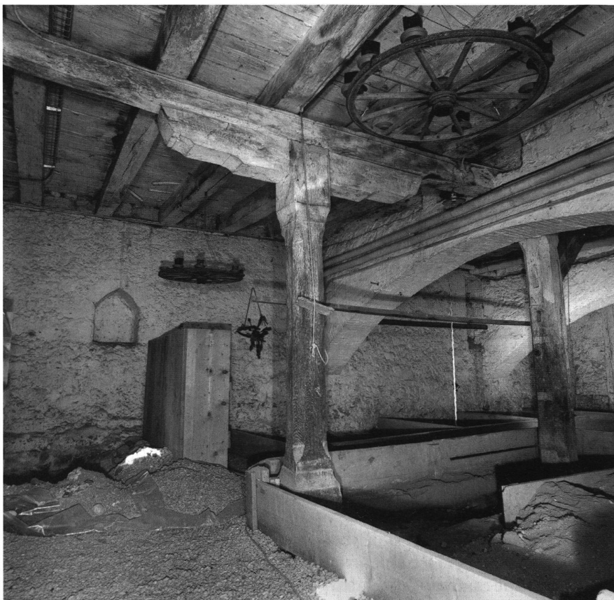
8: Der Keller des Saalgeschossbaues. Sichtbar ist die originale Geschossbalkenlage mit zugehörigem Unterzug und Stütze im Hintergrund. Die Stütze im Vordergrund ist nachträglich, ebenso die beiden Schwibbögen aus Backstein. Blick nach Südwesten.
