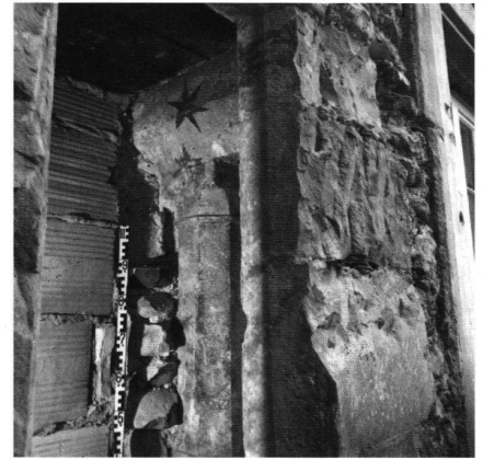
4: «Brunnenturm» (Obere Zäume 26). Im südlich an den Wohnturm angebauten Palas übernehmen um 1300 profilierte Stützen die Last der reich befensterten Wände.
