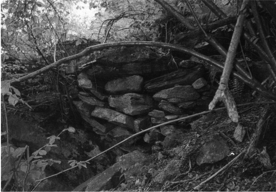
16: Stützmauer M14a an der Terrasse unterhalb der Felswand unter dem Caslasc. Das Mauerwerk gleicht dem Caslasc-Typus stark.
