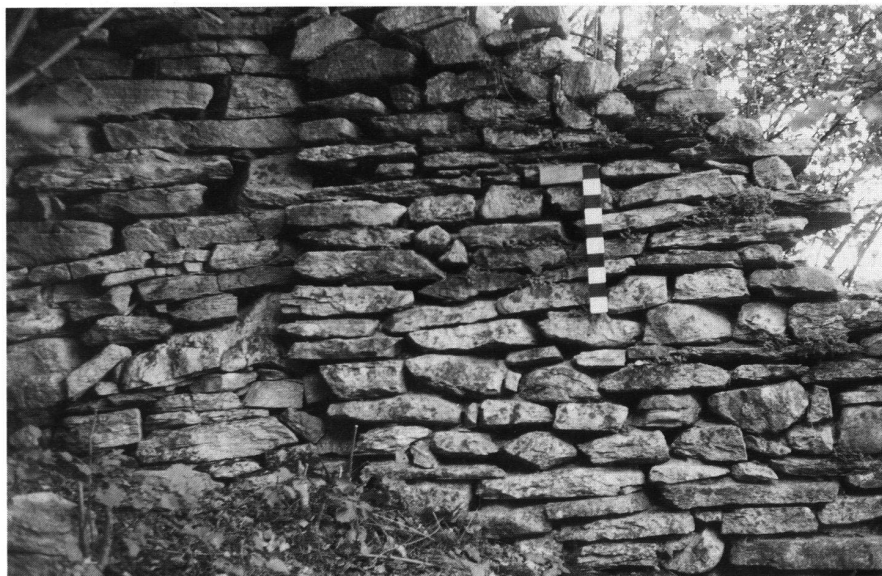
12: Caslasc, Fuge zwischen M4 (links) und M5 (rechts). Bei M5 lassen sich eindeutige Mörtelsspuren feststellen.
