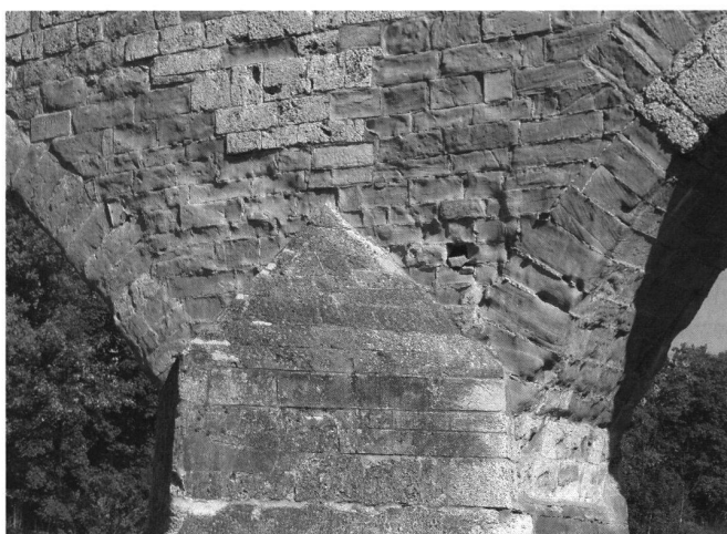
Buntes Mauerbild: Südseite zwischen Bogen 4 und 5. Strömungsabweiser aus grauem Sandstein; Originalsubstanz aus stark abgewittertem Appenzeller Sandstein; ältere Reparaturen aus Rorschacher Sandstein und Tuff. Aufn. AATG.
