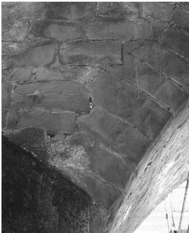
Über 500-jährige Originalsubstanz: engfugig verzahnte Appenzeller Sandsteinblöcke an der Nordseite von Bogen 6. Aufn. AATG.
