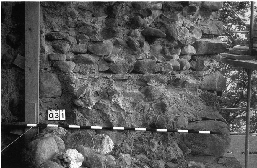
22: Mörtelfuge im Bergfried. Westwand.
