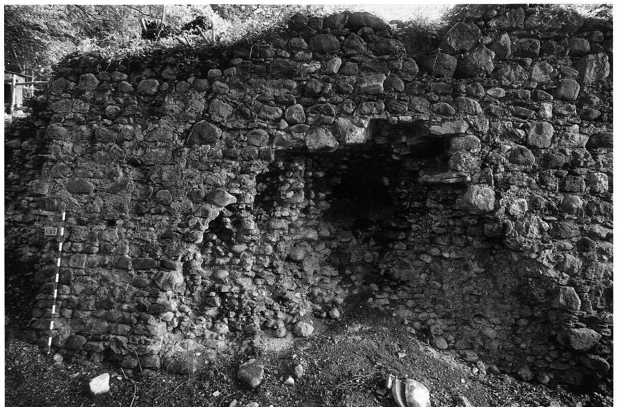
7: Steter Tropfen ... Ausbruch an der Terrassenmauer M24.
