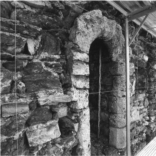
12: Ruine Resti. Rundbogiger Austritt auf den hölzernen Wehrrker der Südfassade. Links neben dem Portal wandbündig abgewitterte Bohlen der westlichen Erkerwand, rechts Lichternische und anschliessend die Lücke der völlig ausgewitterten Hölzer der Ostwand.
