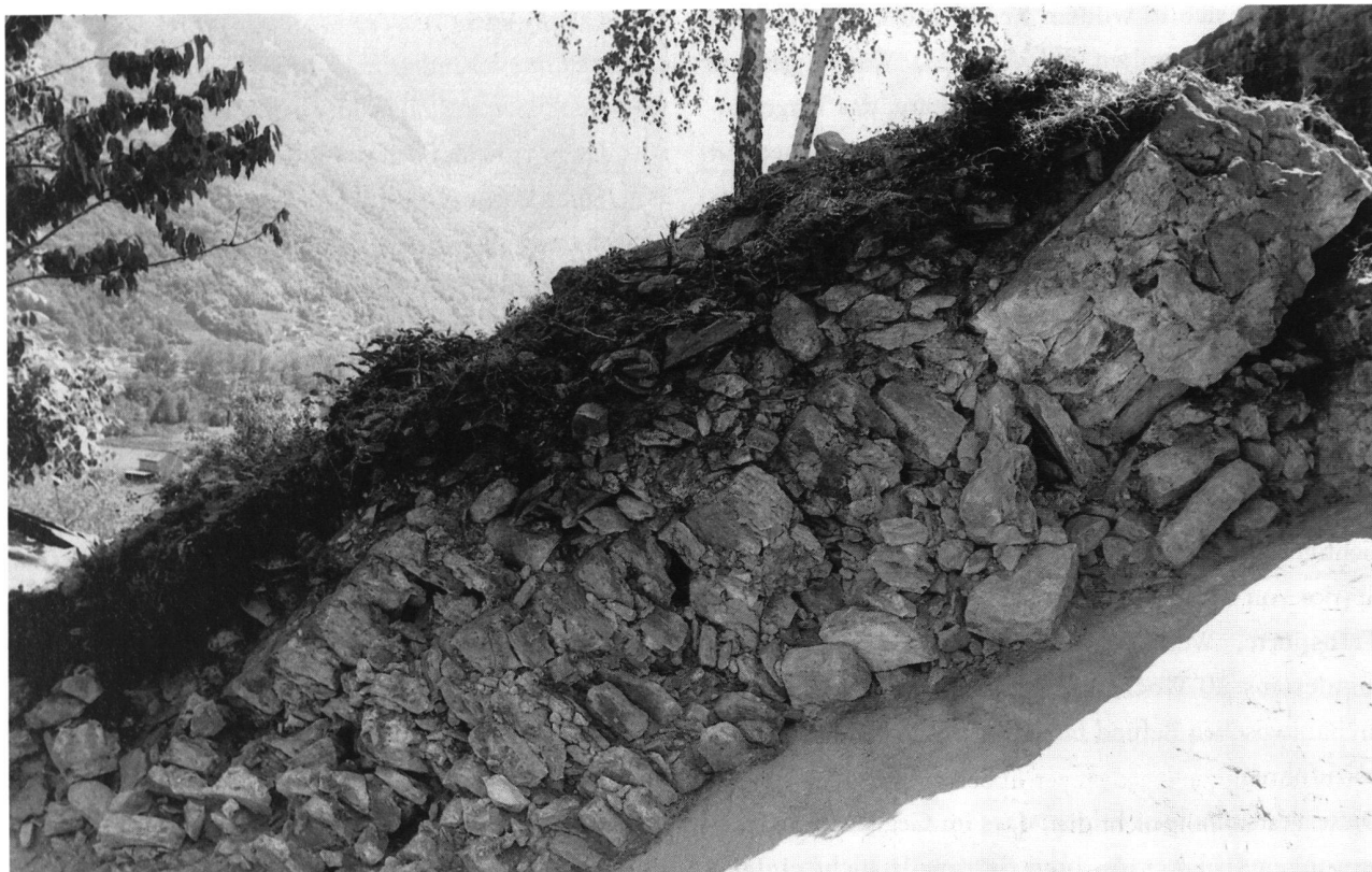
25: Serravalle. Als Folge der Zerstörung von 1402 nach aussen, den Hang hinuntergekippte Umfassungsmauer der Hauptburg (2003).
