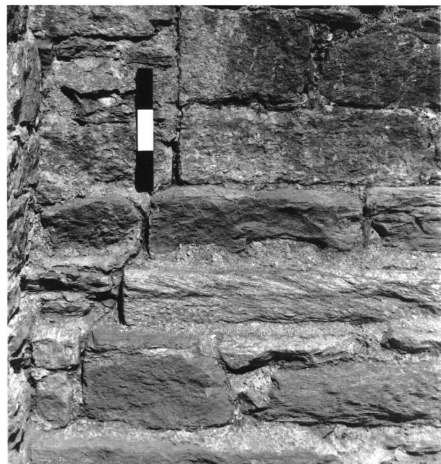
9: Serravalle. Nordwestecke des Hauptbaues E/F/G. Eckverband mit abgetrepptem Fundament. Links mit Stossfuge die Mauer des Latrinenbaues L (2004).
