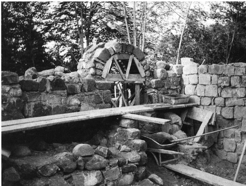
Burgruine Hünenberg: Arbeitsaufnahme bei der Rekonstruktion des Portalbogens, vermutlich 1945/46. Legende auf der Rückseite des Fotoabzuges: «Hinterer Ausgang des Pferdestalles» (Nachlass Emil Villiger).
