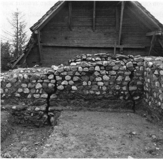
8: Gams SG. Östliche Umfassungsmauer von innen mit den vom Erdbeben verursachten Vertikalrissen.
