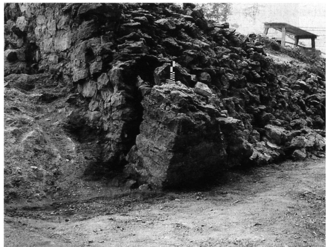
14: Altenberg. Bodensenkungen führten zum Abreißen des Aussenmantels auf einem längeren Abschnitt der Ringmauer.
