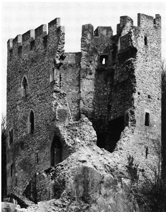
15: Neu-Thierstein SO. Ansicht von W (1985 und 1997). Nebst der schlechten Bauweise führten die im 19. Jahrhundert eingebrochenen resp. veränderten Öffnungen zum Teileinsturz von 1997.
