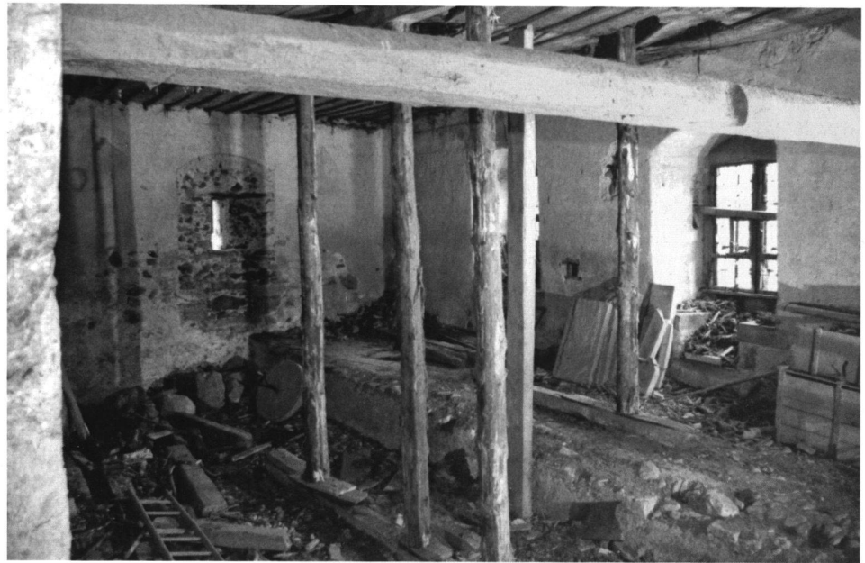
4: Der Rittersaal mit notdürftig abgestützter Decke 1978.
