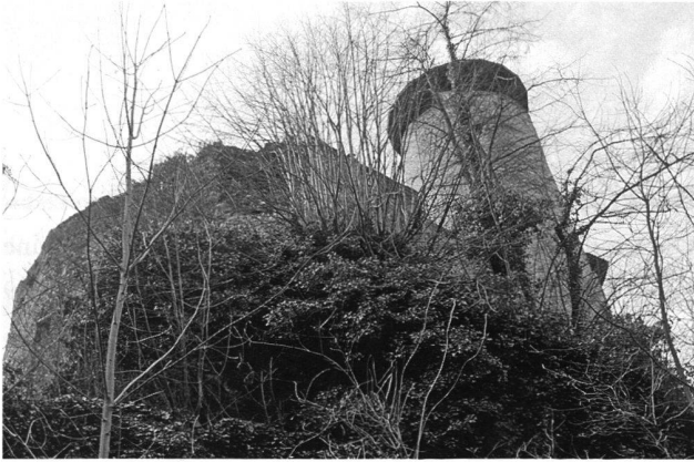
2: Arlesheim-Birseck, nördlicher Bering und Rundturm, Zustand im Februar 2000 nach dem Absturz einer Mauerpartie.
