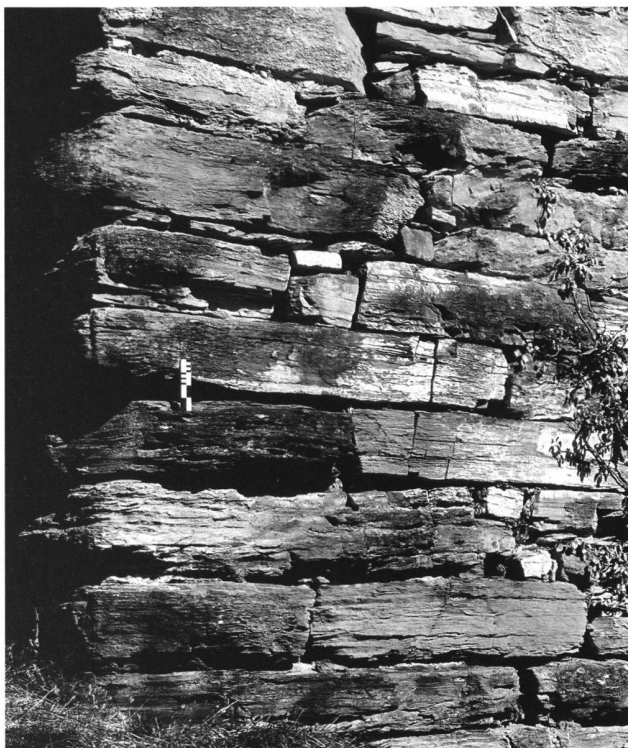
3: Turm, Mauer M2. Senkrecht zur Schichtung geborstene Mauersteine neben der Ecke M2/M3, von S.
