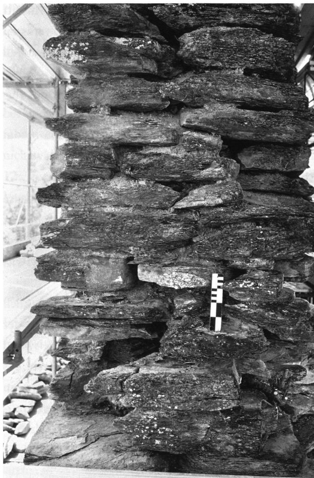
4: Turm, Eckverband M1/M2. Stark ausgewaschenes Mauerwerk der Aufstockung oberhalb des Balkenlochs 2.7, von ONO.
