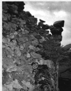
Vorzustand 2001: Die Mauerkrone ist völlig aufgeklüfft, die Ecken können jederzeit einstürzen.
