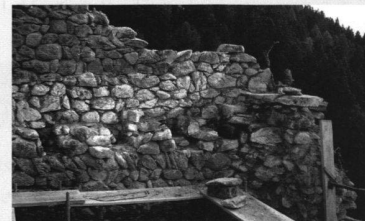
Vorzustand 2004: Balkenlage des dritten Geschosses. Rechts die Torschwelle des Hoheinganges, gut acht Meter über Boden.
