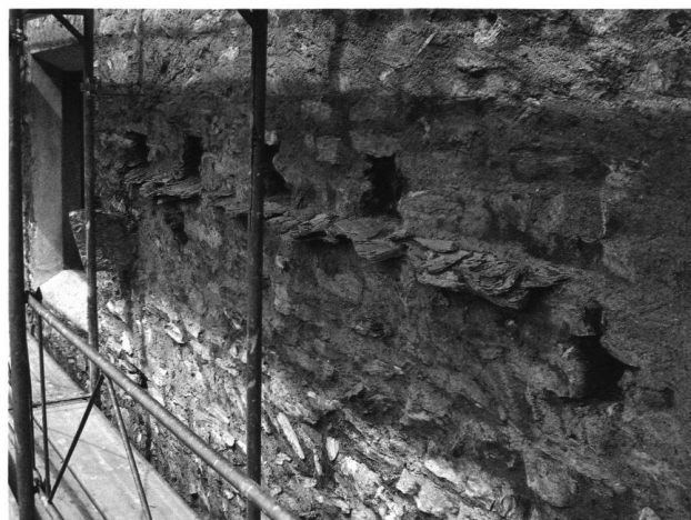
11: Palas-Südfassade. Detail der vorkragenden Steinplatten des ehemaligen Satteldaches mit den Ausgusslöchern des Zinnenkranzes und eine Steinkonsole für die Befestigung der Dachrinne. Aufnahme von 2006.
