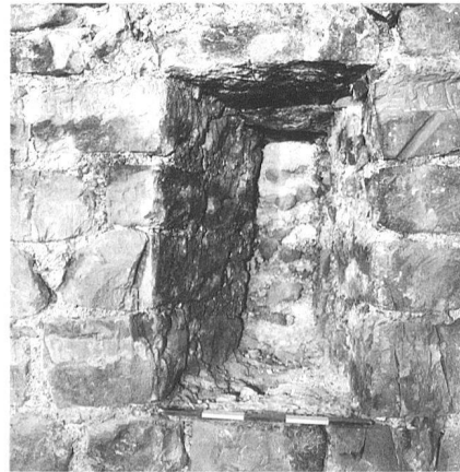
28: Kernbau II, EG, Fenster 9.2.
