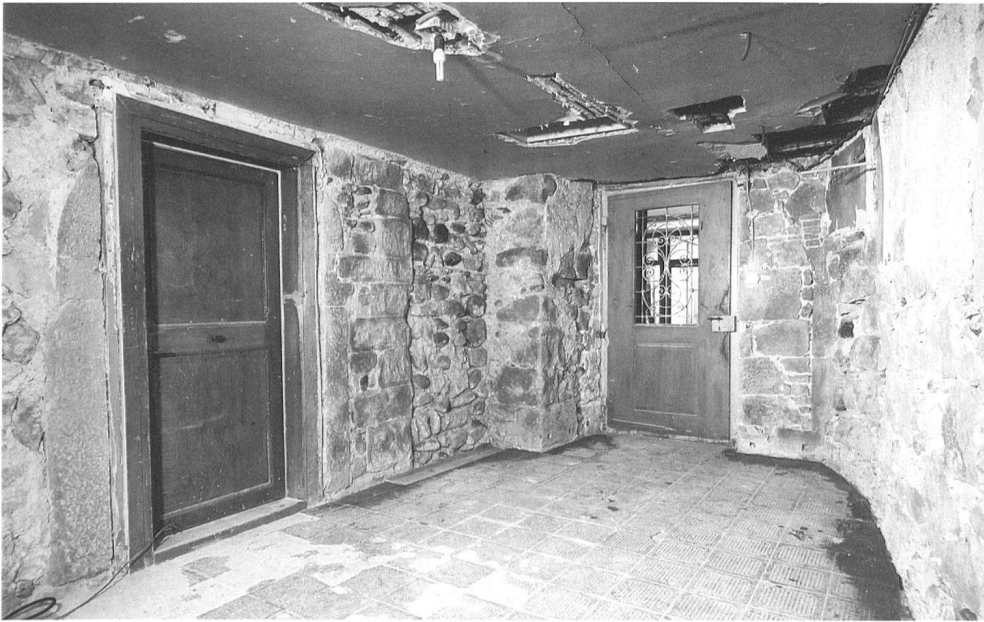
11: Erdgeschoss der Nord-Erweiterung von 1343 (d) des Kernbaus III von Süden. Linkerhand befindet sich der Kernbau I (4) mit der nachträglich eingebrochenen Türe (16.6). Daran schliesst die Mauer (16) an, an welche die Nordost-Fassade (18) mit der Türe (18.1) stösst. Die Binnenmauer (20) rechterhand entstand frühestens 1469 (d).
