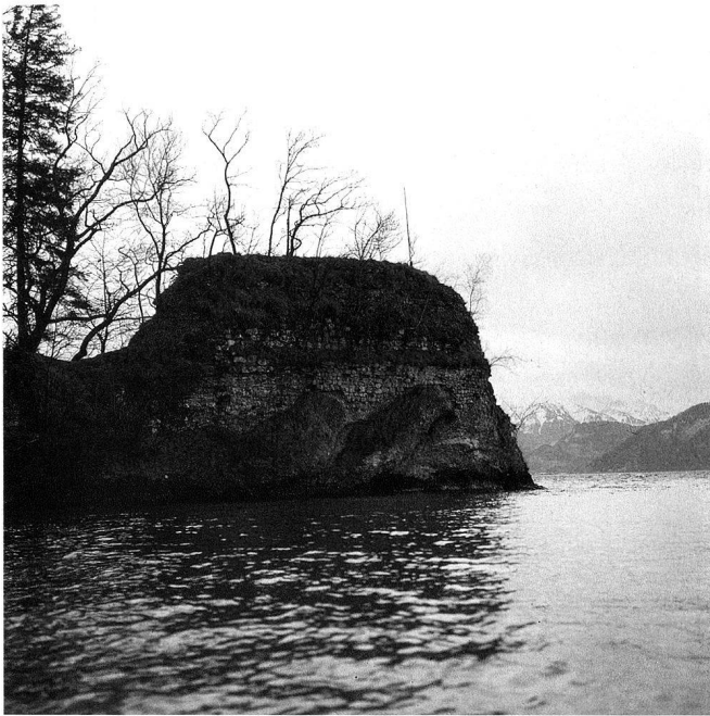
5: Ruine und Insel Altstaad am Meggenhorn 1999. Vom Absturz bedrohtes Mauerwerk auf der Westklippe der Insel.
