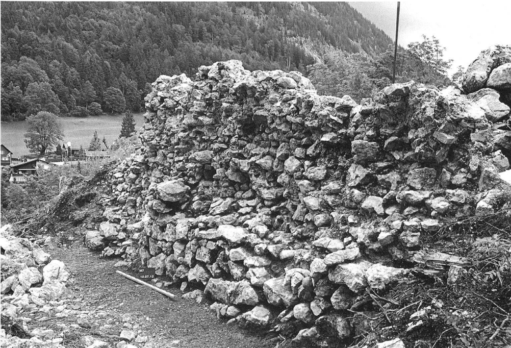
11: Wildhaus-Alt St. Johann SG, Wildenburg. L-förmiger Bau, Mauer M7. Freigelegte, stark zerfallene Westfront, von Südwesten.
