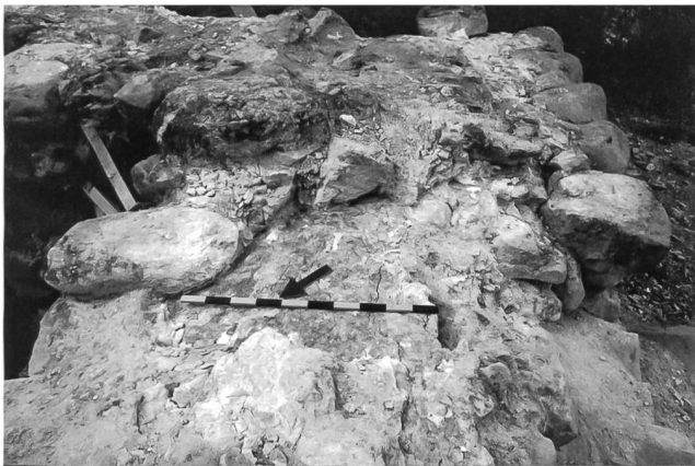
12: Auf der Mauerkrone des Bergfrieds fanden sich nach der Reinigung Reste einer verschmutzten Mörteloberfläche, die als sogenannte Wintergrenze einen Bauunterbruch markiert. Befundaufnahme von 2007.
