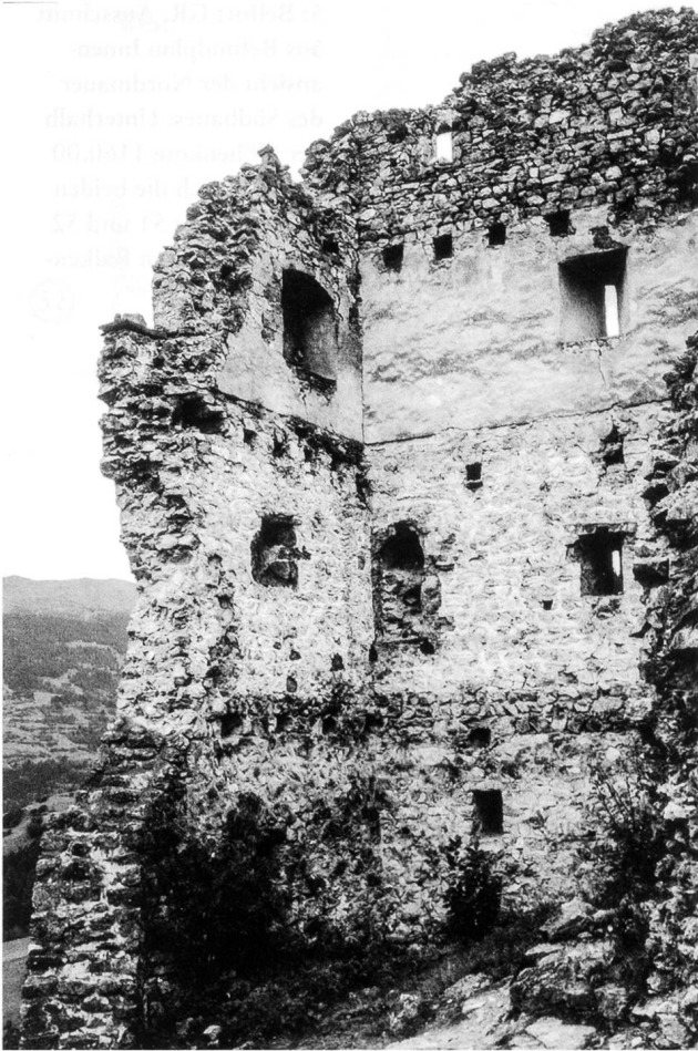
4. Belfort GR. Blick in die Südwestecke des Südtraktes. Die Kanalöffnung liegt unterhalb des Stichbogenfensters auf Unterkanthöhe des deckenden Verputzes in der Südmauer (links; 1999).
