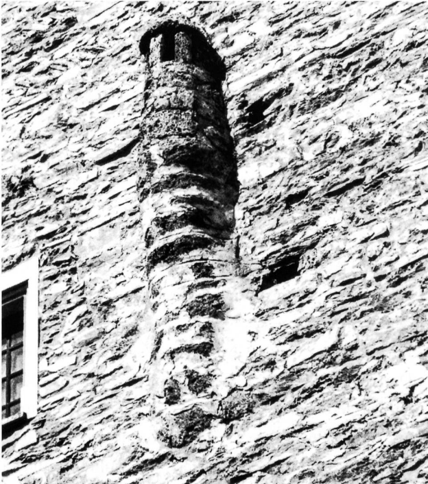
12: Venthône VS. Fassadenschornstein an der so genannten Aula magna.
