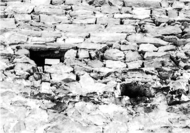
15: Ober-Ruchenberg GR. Innenansicht der östlichen Turmmauer. Fotografie steil aufwärts, deshalb Durchsicht durch den schräg nach oben ziehenden Abzugsschacht, tiefer rechts Auflagerloch des südlichen Unterzugs.
