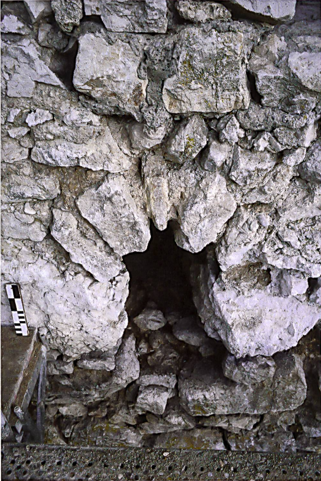
25: Pfeffingen BL. Südliche Zwingermauer. Ausfluss an der Aussenseite.
