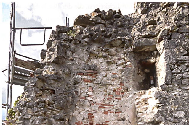
39: Pfeffingen BL. In die südliche Giebelwand des «alt geheüss» wurde beim Einbau eines offenen Kamins ein Rauchabzug eingearbeitet. Blick von Norden.
