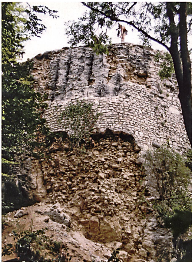
54: Pfeffingen BL. Nachdem sich Teile des äusseren Mauermantels der Schildmauer gelöst hatten, wurden sie grossflächig durch Sprengungen entfernt, 1989.
