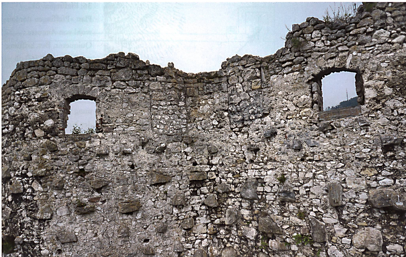
35: Pfeffingen BL. Nordmauer des Wohnturms, Ansicht von Norden. Bei der Erhöhung der Nordmauer wurden die Zinnenzwischenräume entweder zu Fenstern umgebaut oder zugemauert. Die heute vorhandenen Zumauerungen stammen allerdings von der Sanierung in den 1930er Jahren, nachdem die Zinnenzwischenräume wieder geöffnet worden waren. Foto 2012 vor der Sanierung.
