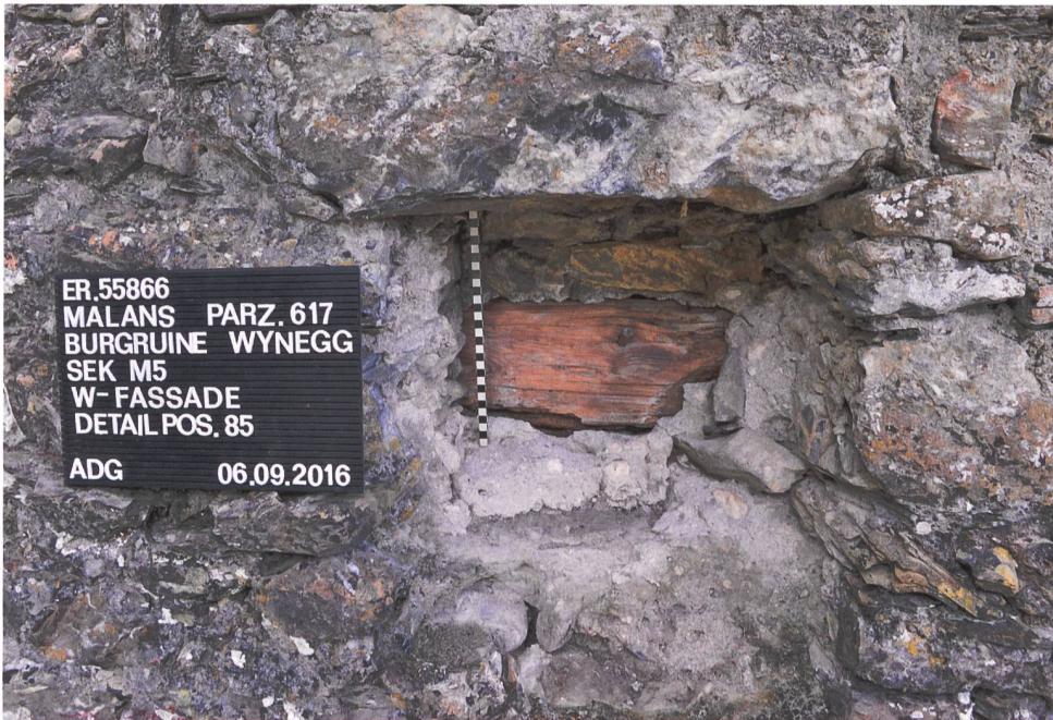
25: Wynegg GR. Sek M5, Ostansicht. Detailaufnahme eines Armierungsholzes, einsehbar im rückwärtigen Bereich eines Balkenauf-lagers des 1. Obergeschosses (Aufnahme 9.6.2016).
