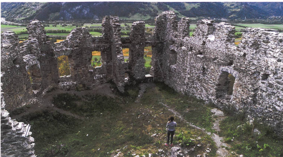
19: Wynegg GR. Übersichtsaufnahme Palas nach Sanierung, Sek M5, M6, M8, M9, nach Süden. Phase 7, Ausbau der Anlage durch Johannes Guler (Aufnahme 23.10.2019).
