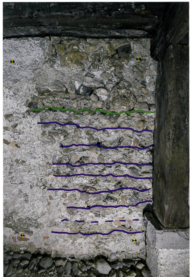
11: Stein am Rhein SH, Brodlaubegass 15. Südwand Keller. Die nachträgliche Unterkellerung geschah durch das Unterfangen des bestehenden Fundaments (grüne Linie) um jeweils zwei bis drei Steinlagen (violette Linien). Blick nach Süden.
