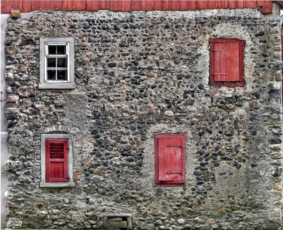
5: Stein am Rhein SH, Brodlaubegass 15. Nordfassade mit starker Brandrötung. Blick nach Süden.
