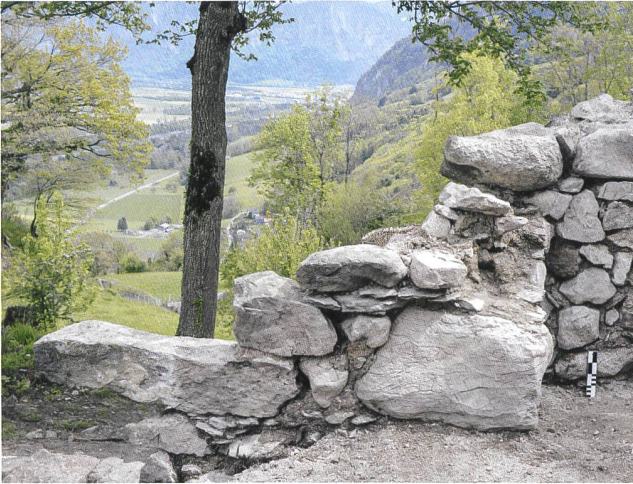
13: Pfäfers SG, Ruine Wartenstein, 2019. Untere Burg, Tor, von Südosten. Der auf dem Bild weit auskragende lange Stein links unten könnte Teil des südwestlichen Torgewändes gewesen sein. Die lediglich 70 cm breite Ringmauer M207 ist neben dem Tordurchgang gegen innen um 60 cm verstärkt, auf einer Länge von knapp 2 m.
