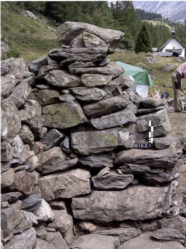
8: Blatten (Lötschen) VS, Kühmatt 2019. Haus H19, Mauer M19.2-1 (innen) von Südwesten. Die Mauer ist durch Schnee- und Eisdruck abgekippt. Das in Phase II aufgeführte Mauerwerk läuft in der Ecke auf die unterste, im Bild noch sichtbare Lage der Mauer M19.1.
