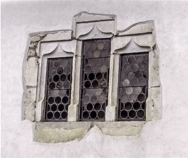
6: Beim Haus Rue de Kiffis 6 von 1538–1542d hat sich im Obergeschoss ein gotisches Staffelfenster der einstigen Stube erhalten. Das Fenster wurde 1974 restauriert.
