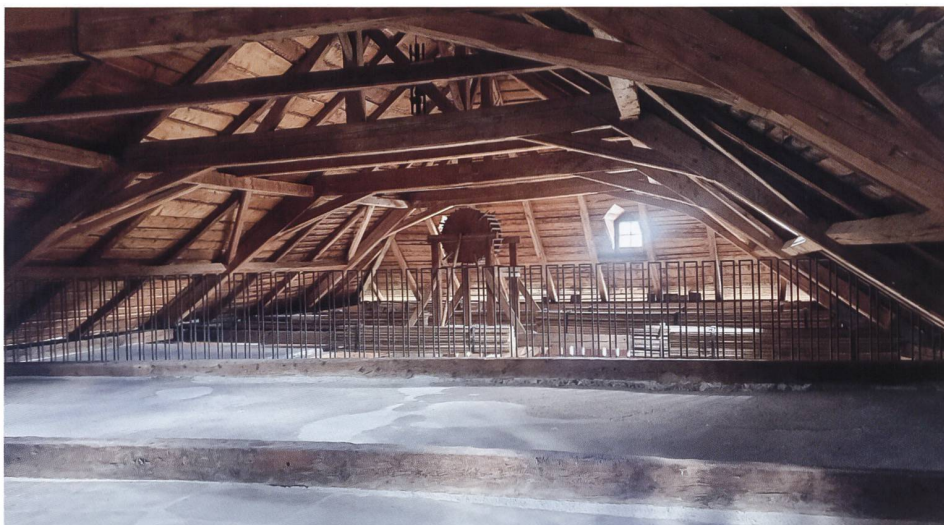
19: Zuoz, Chesa Gregori. Liegender Dachstuhl mit eingezapften Kopfstreben von 1791d. Blick gegen Süden.
