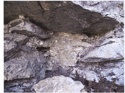
5: Herausgefallene Steine erlauben den Blick in das Innere der Südwestmauer: Einsatz von Kalkmörtel.
