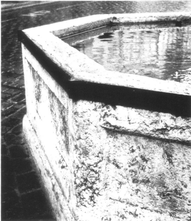
Abb. 7 Becken des Gerechtigkeitsbrunnens in der originalen Form von 1543. Einige der Platten vielleicht noch ursprünglich (alpiner Kalkstein), die andern in Solothurner Stein erneuert.
