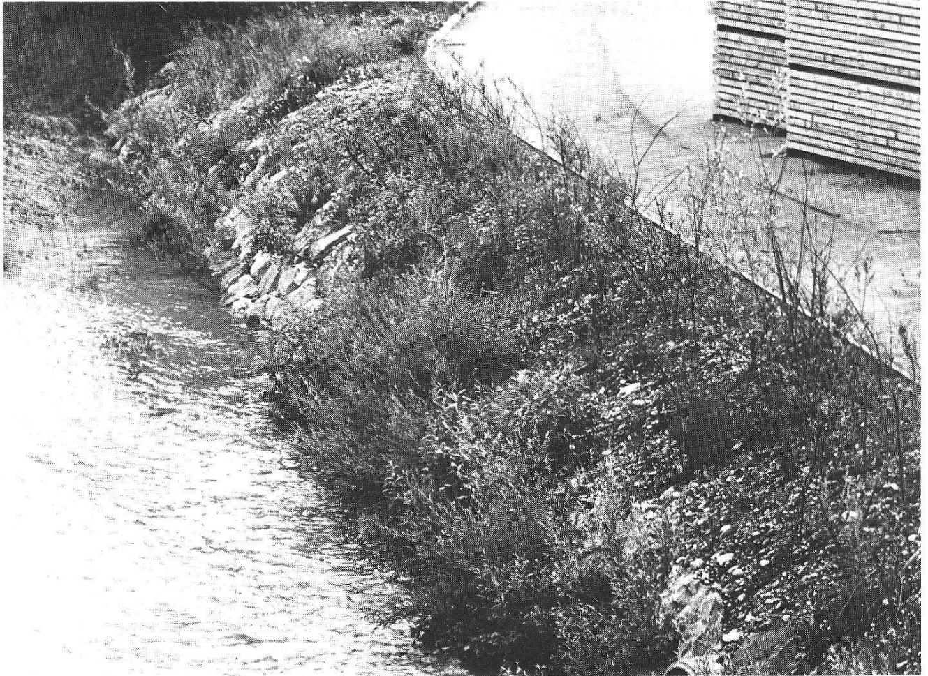
Abbildung 3: Emme-Ufer; mit Blockwurf und Lebendverbau (Weidenstecklingen) gesichertes Ufer. Wie das Bild zeigt, ist diese Verbauungsart bei günstigen Böschungsverhältnissen auch auf kleinem Raum anwendbar.
