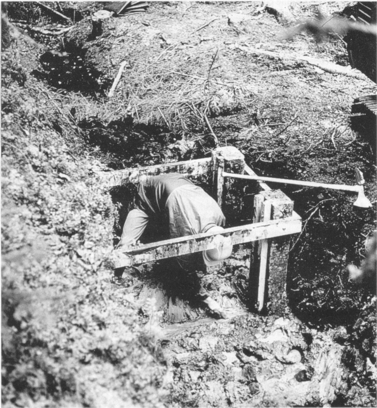
Figure 3: Construction du système de régulation: mise en place du noyau de marne. (Photo Ph. Grosvernier)
