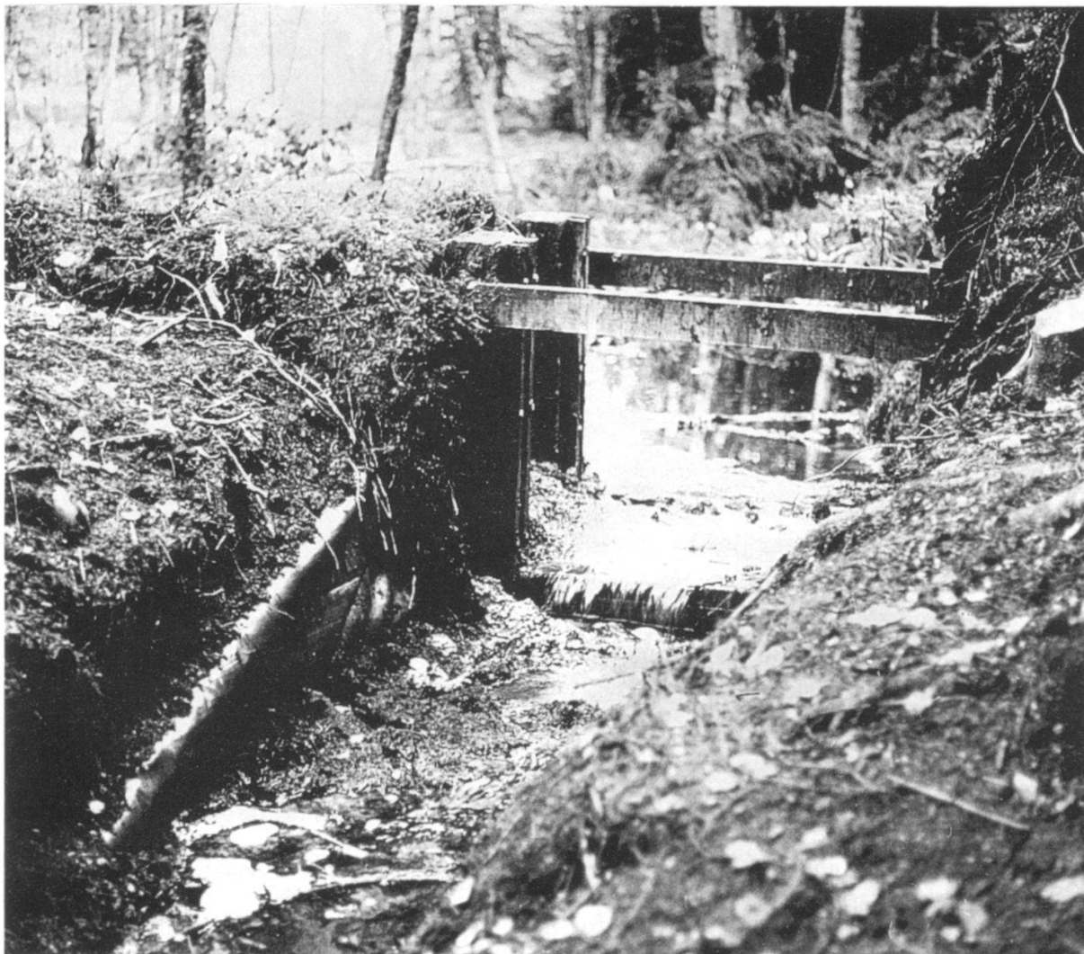
Figure 4: Quelques jours après les travaux: le trop-plein fonctionne. (Photo Ph. Grosvernier)
