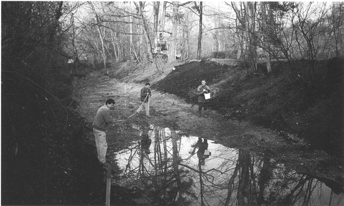
Abbildung 11: Ausbaggerung von verschlammten Tümpelbereichen. Die variierenden Tiefen des Aushubes gewährleisten verschiedene Lebensräume für wasserbezogene Lebewesen. (Foto: P. Weber, Dezember 1994)
