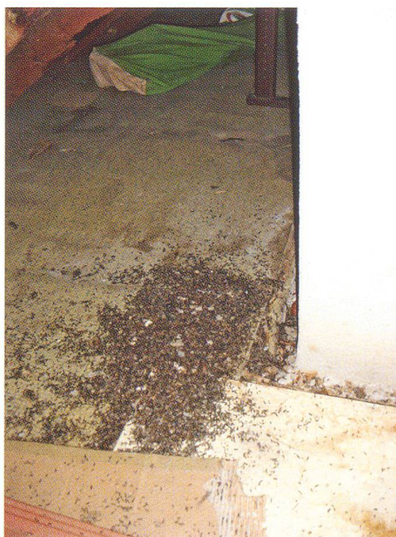
Figure 22: Les crottes s'accumulent à divers emplacements du grenier. (Photo: BIF/Ch. Brossard)
