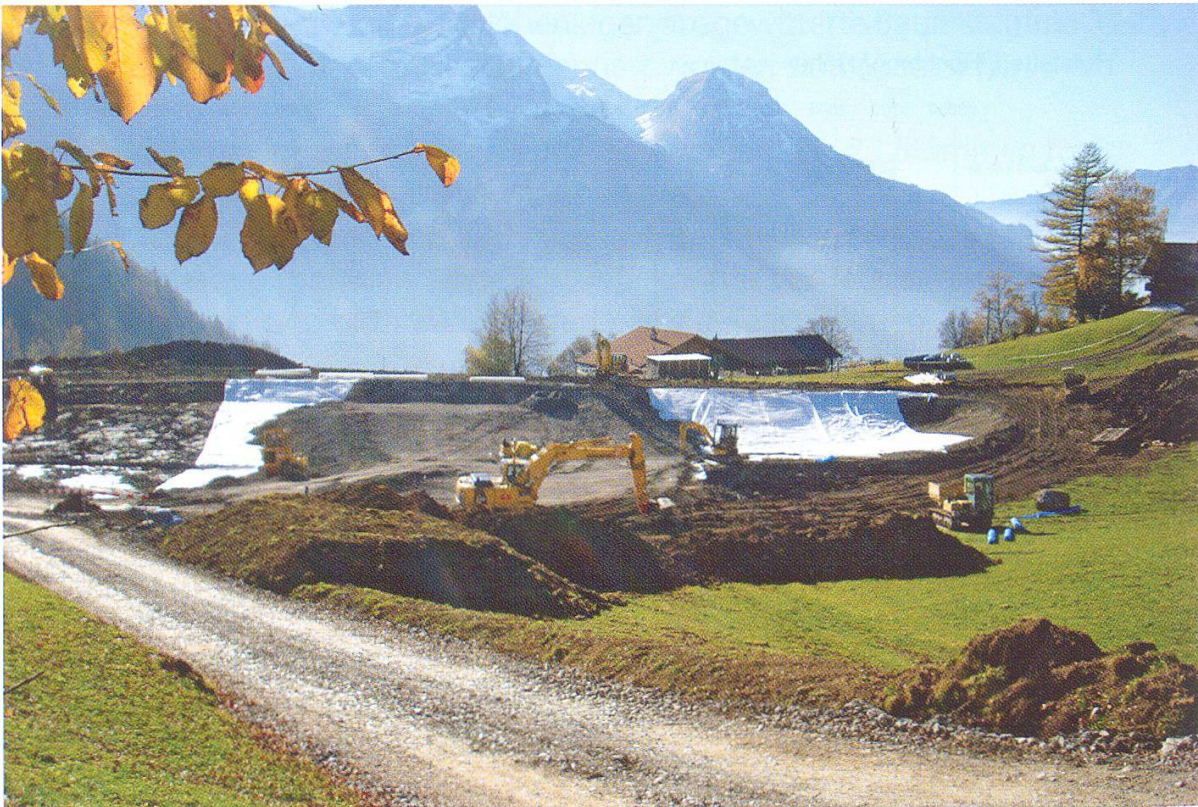
Abbildung 33: Während der Bauarbeiten für den Badesee Wysstannen bei Wasserwendi, Hasliberg, wurde eine grosse Torfzone mit einer hohen Dichte an subfossilen Hölzern abgegraben. (Foto: M. Schmidhalter)
