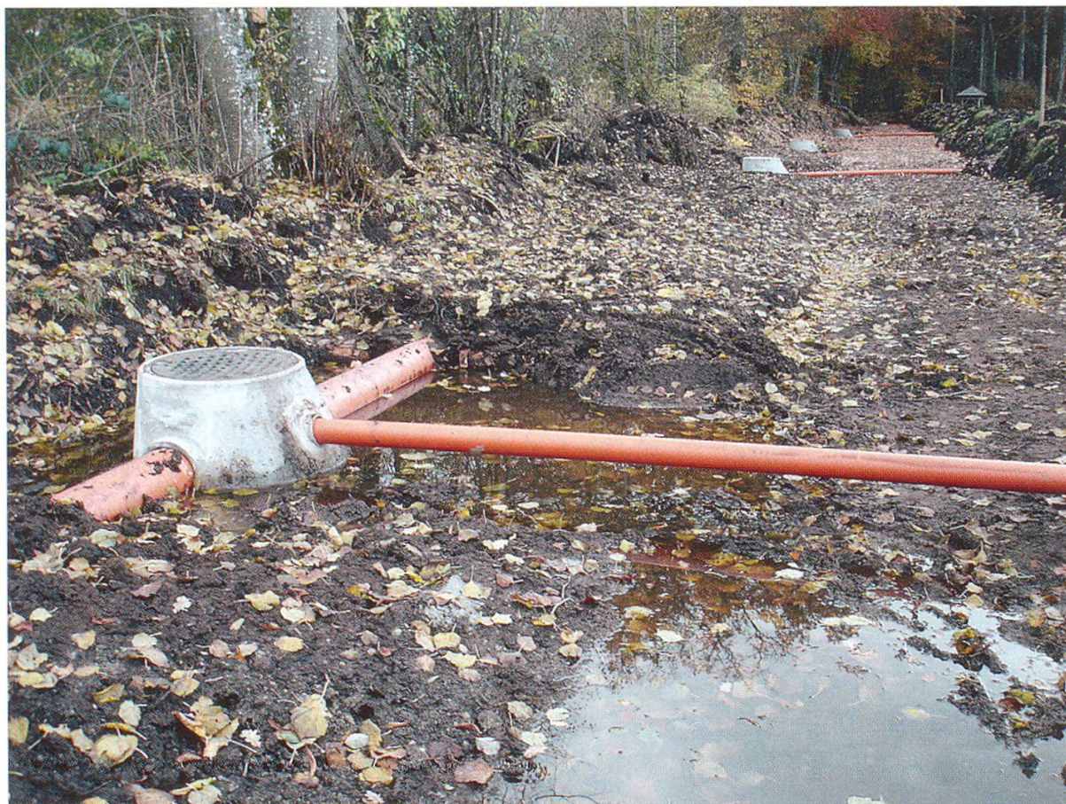
Abbildung 9: Geschlossene Hauptleitung mit von rechts einmündenden Drainagerohren während des Baus. (Foto: Thomas Leu)
