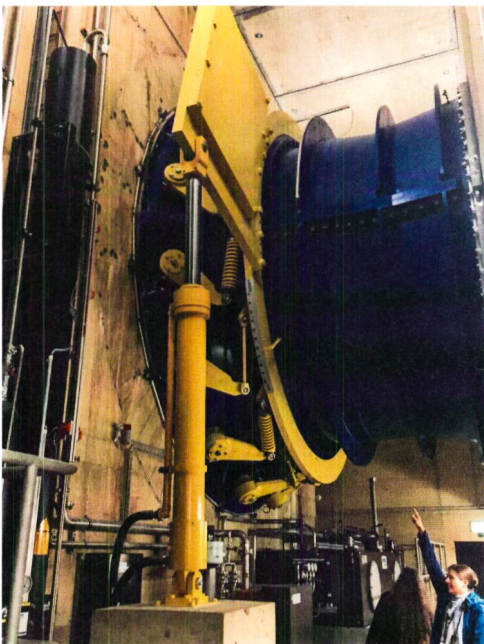
Beeindruckender Drehschieber, welcher den Wasserfluss zur Turbine regelt.
