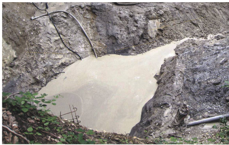
Tafel 1, Foto 2: Zielschacht Westseite. Wechsellagerung von tonig-siltigen Kiesbänken mit Lehmlagen, beige- bis schwarzgrau gebändert, Schichtung flach gegen rechts (See) einfallend.
