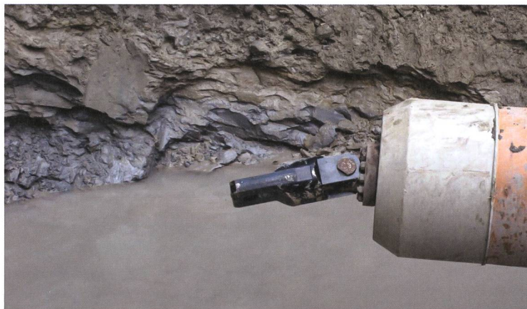
Tafel 1, Foto 4: Detail von Foto 2 links unten und Foto 3 rechts unten anschliessend. Beige-grau gebänderte tonige Siltschicht zwischen vorbelasteten Kiesbänken gelagert. Kiesbänke dicht in tonig-siltige Matrix gepackt wie Grundmoräne.
